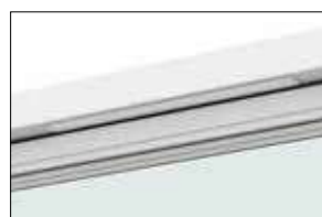
Friskluftsentil. Fri öppning på 40cm 2 . Inte synlig utillfrån. I fasta karmar med utvändigt täcklock.
